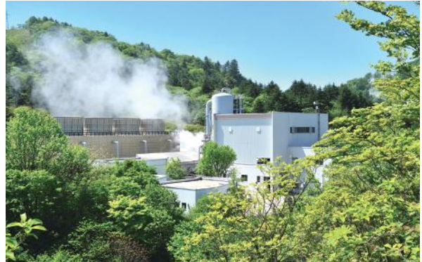
鬼首地熱発電所(宮城県)
