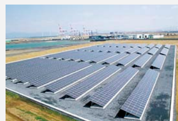
響灘太陽光発電所(北九州市)
