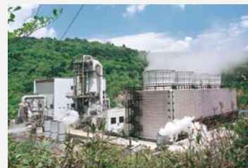
鬼首地熱発電所(宮城県)
