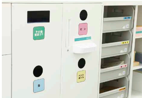
各オフィスに設置してある廃棄物分別容器(J-POWER本店)
