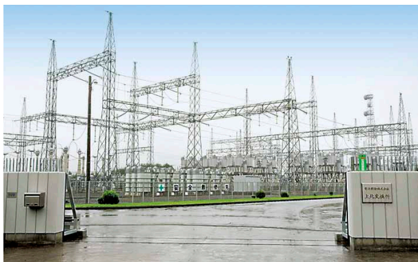
北本連系設備 上北変換所 (青森県)
