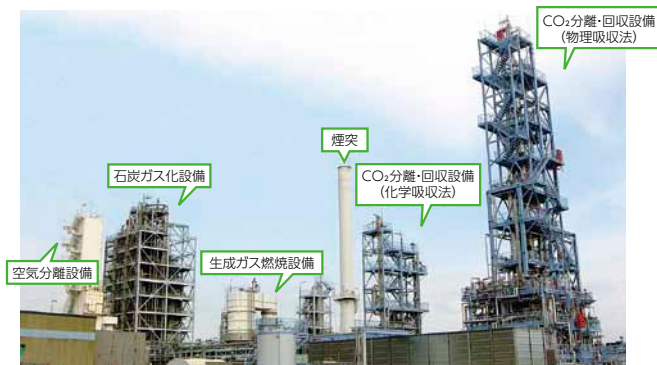
EAGLEパイロットプラント試験設備外観（北九州市）
