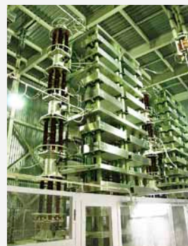
北本連系設備 函館変換所（函館市）
