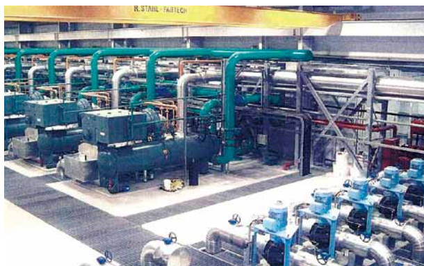
熱供給プラント内観
