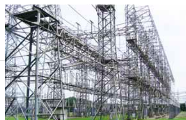
南川越変電所(埼玉県)
