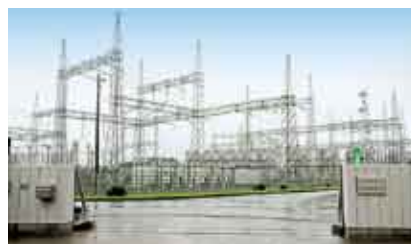
北本連系設備 上北変換所（青森県）
