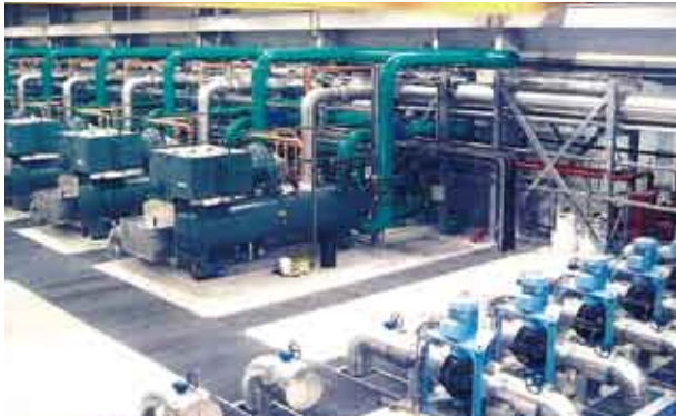
熱供給プラント内観
