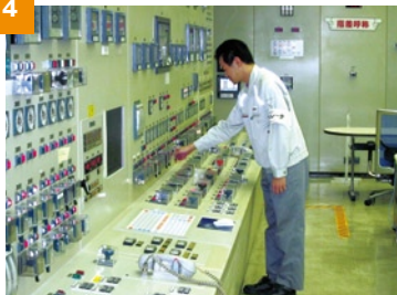
中央制御室での監視
