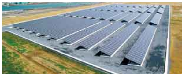
響灘太陽光発電所(北九州市)
