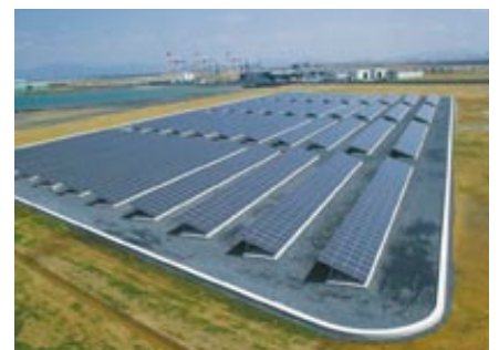
響灘太陽光発電所（北九州市）
