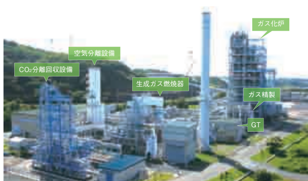
EAGLEパイロットプラント試験設備外観(北九州市若松区)
