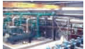
熱供給プラント内観
