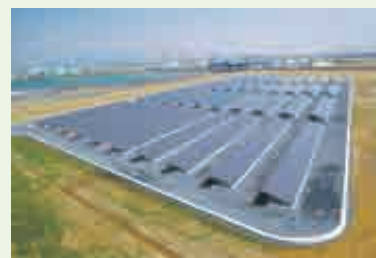
響灘太陽光発電所(北九州市)
