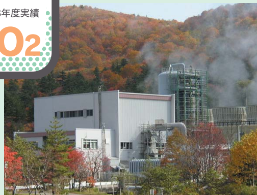
鬼首地熱発電所(宮城県)
