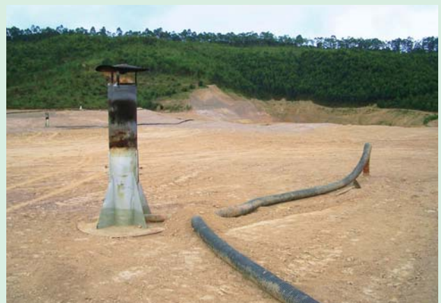
廃棄物処分場でのランドフィルガス回収井戸
