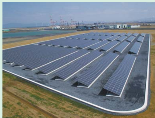
響灘太陽光発電所(北九州市)
