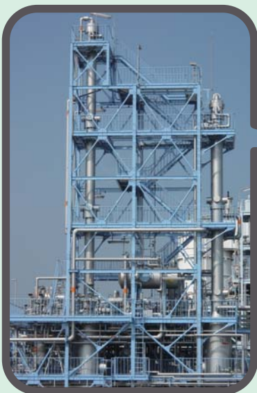
CO 2 分離回収装置
