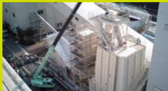
木質バイオマス受払設備（松浦火力発電所、長崎県）
