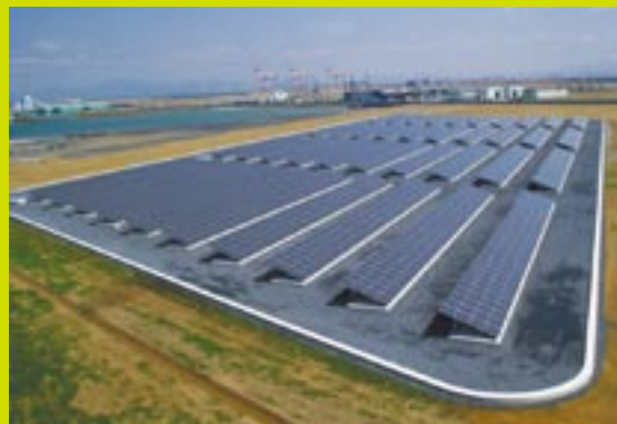
響灘太陽光発電所（福岡県）
