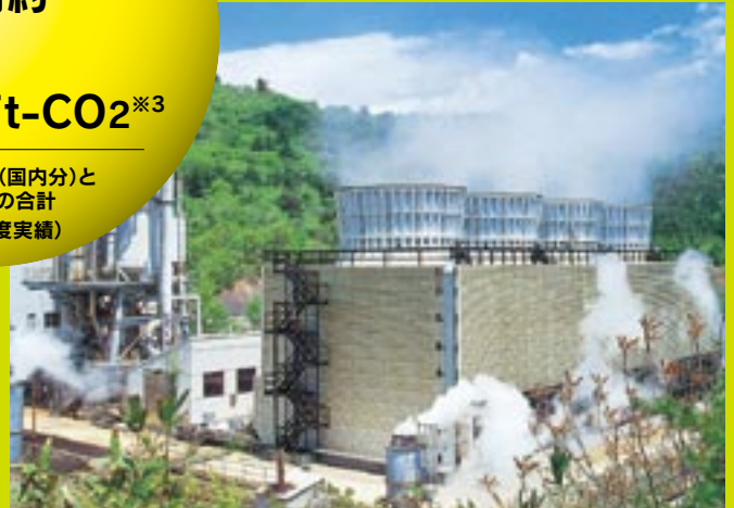
鬼首地熱発電所（宮城県）
