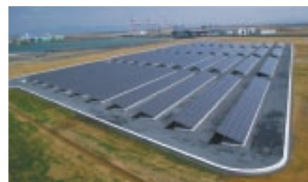
太陽光パネル
