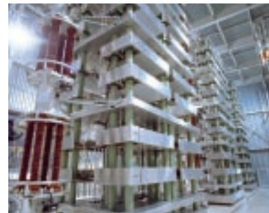
北本直流連系設備 (函館変電所サイリスタバルブ)
