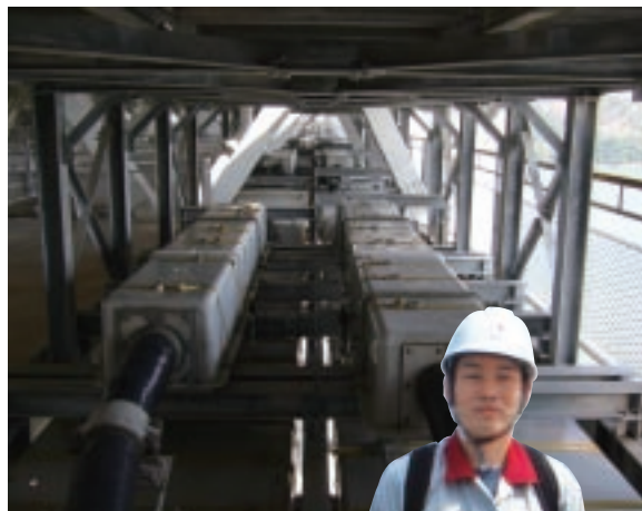
瀬戸大橋に設置された50万ボルト送電ケーブル
