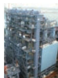
磯子火力発電所新2号機乾式排煙脱硫装置
