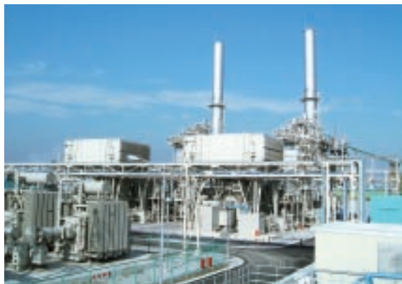
市原発電所((株)ベイサイドエナジー、千葉県)
