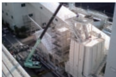
木質バイオマス受払設備 (松浦火力発電所、長崎県)
