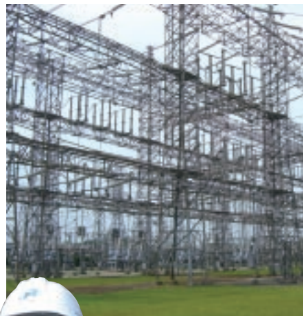
南川越変電所
