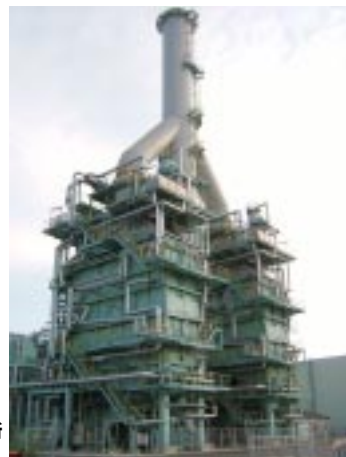
市原パワー(株)市原発電所 (千葉県)
