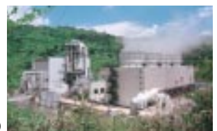
鬼首地熱発電所(宮城県)
