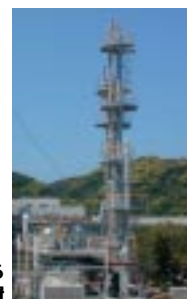
松島火力2号機における CO 2 分離回収実証試験装置
