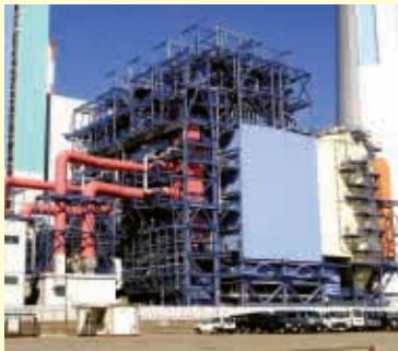
磯子火力発電所新1号機 (神奈川県) 乾式排煙脱硫装置
