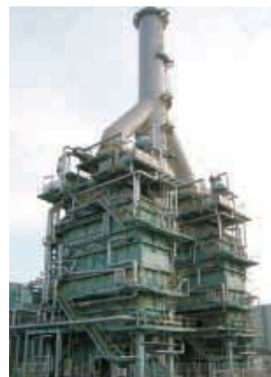
市原パワー(株) 市原発電所(千葉県)
