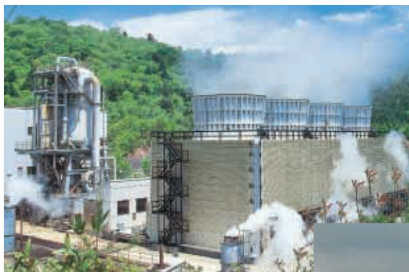
鬼首地熱発電所(宮城県)
