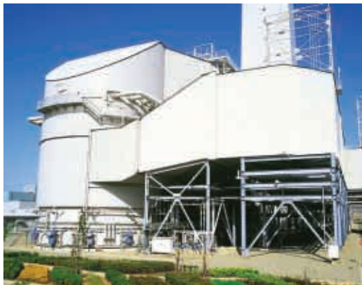
湿式排煙脱硫装置
