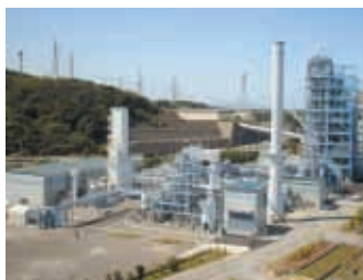
燃料電池用石炭ガス製造技術パイロットプラント(福岡県)
