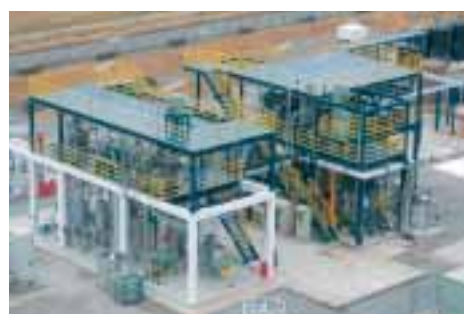
機能性木質新素材製造実証プラント(林野庁補助事業)
