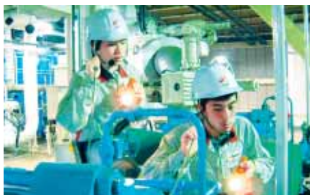
聴音によるポンプの点検(礪子火力発電所)
