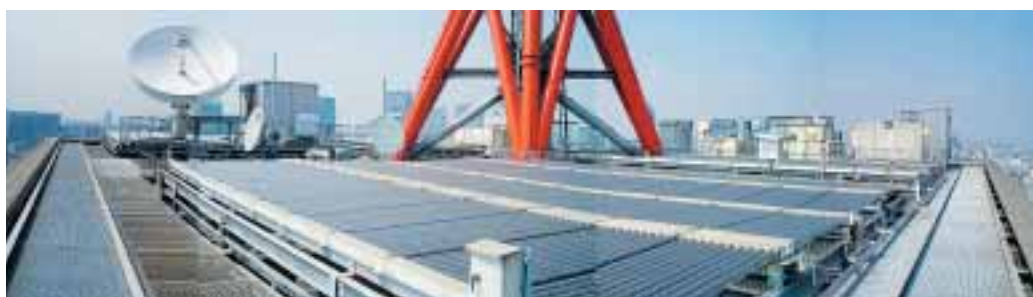
館内給湯用ソーラーパネル(本店ビル屋上)
