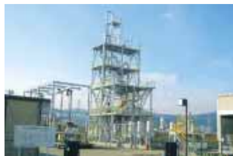
食品廃棄物石油代替プラスチック製造実証プラント(農林水産省補助事業)
