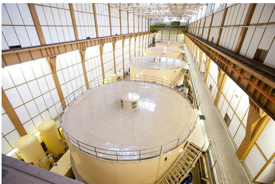
写真：佐久間発電所 4 台の発電機
