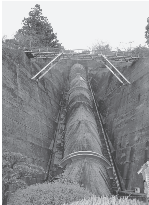
十津川第二発電所の水圧鉄管路。
