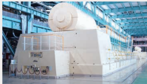
島内から望む発電所(上)と内部のタービン(下)
