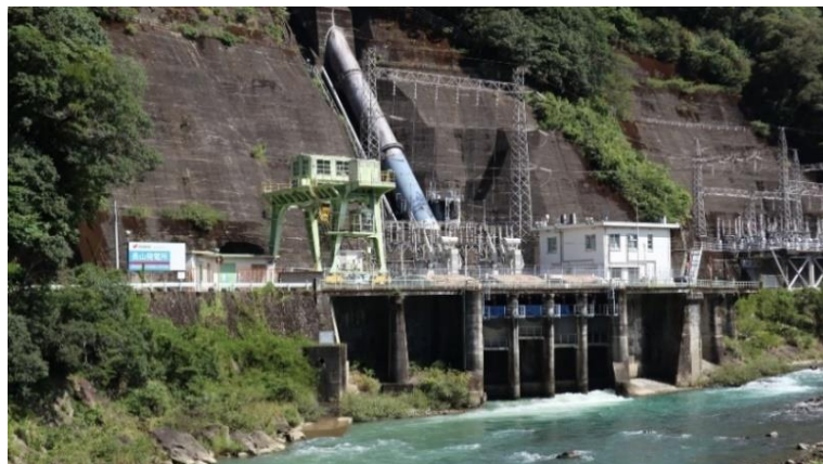
長山発電所（外観）
