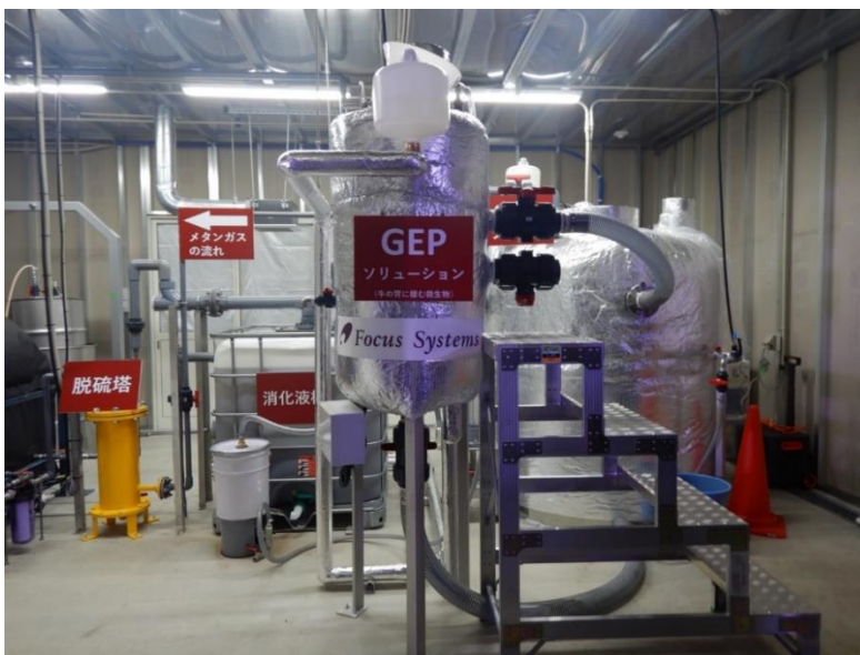
写真：環境微生物研究所のメタン発酵装置
