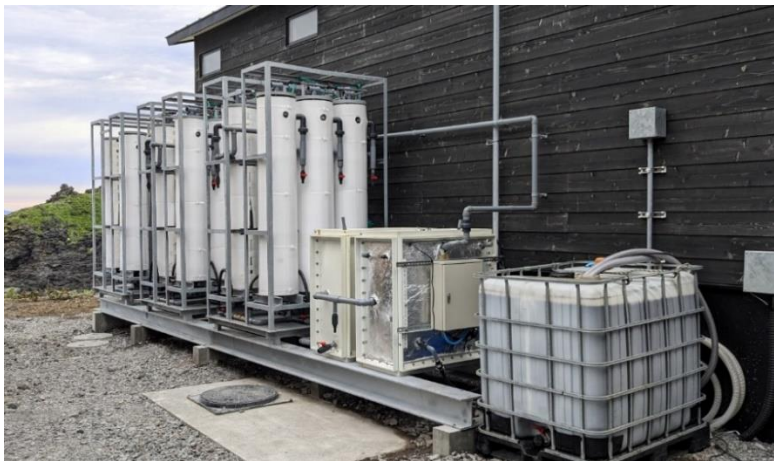
写真：ワタスミの有機排水処理装置
