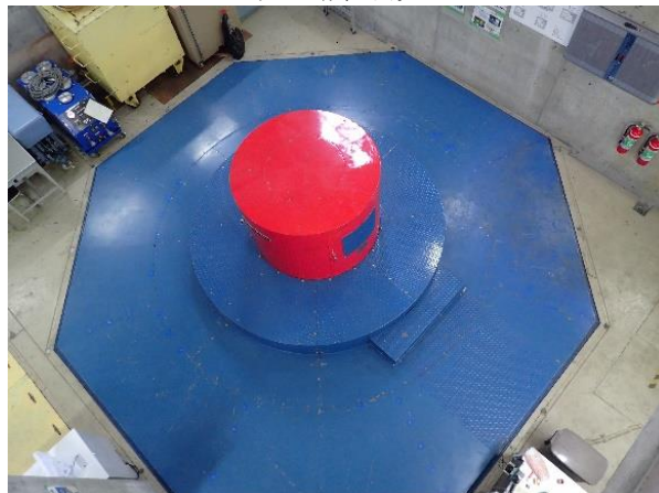
発電所内部（発電設備）
