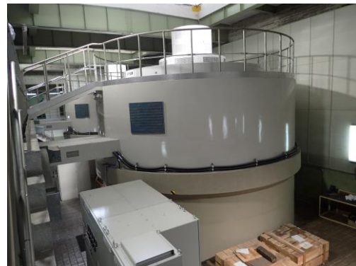
発電所内部（発電設備）
