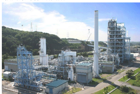
酸素吹石炭ガス化および CO 2 分離・回収の実証試験
