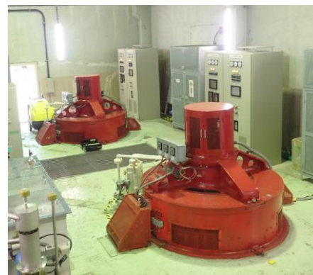
発電所内部（発電設備）
