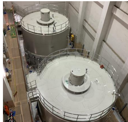
発電所内部（手前が1号機、奥が2号機）
