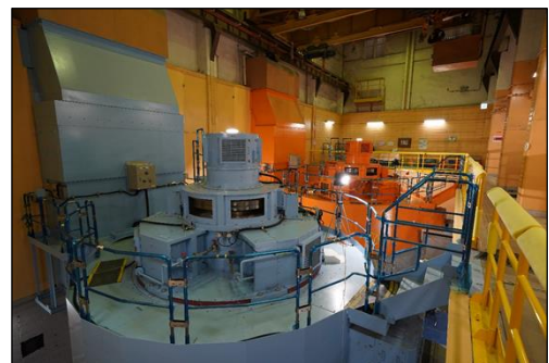
発電所内部（2022年5月24日撮影）
