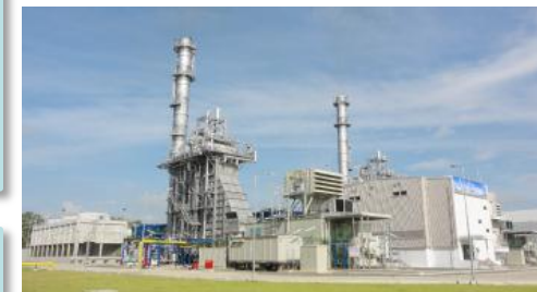
タイ国・サラブリNK2コジェネレーション 発電所
