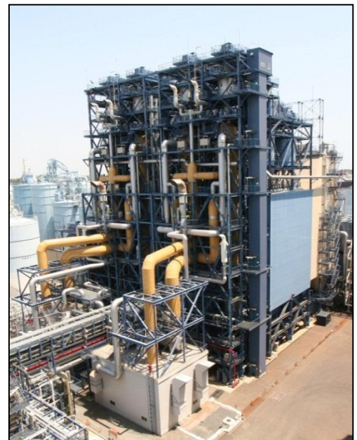
ReACT (J パワー磯子火力発電所新 2 号機)
