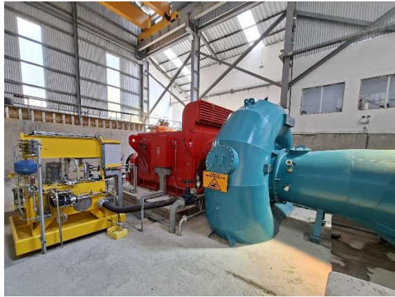
Pungga発電所（内観）
