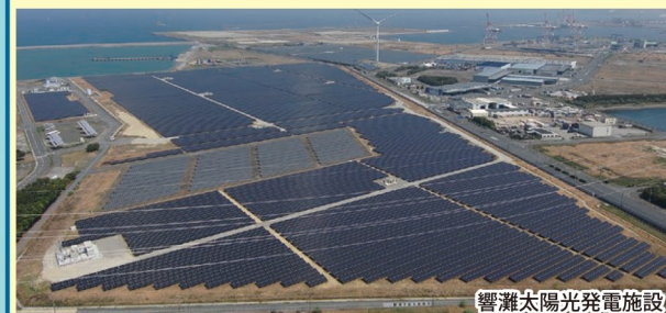
響灘太陽光発電施設
