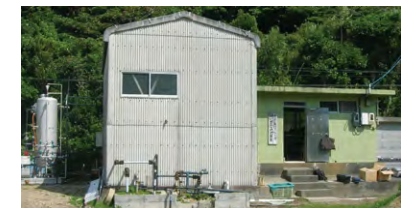
分散型水道 (伊島簡易水道)
