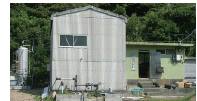
分散型水道(伊島簡易水道)
