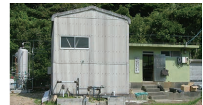
分散型水道(伊島簡易水道)
