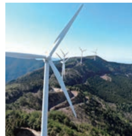
2015年より三菱重工製風車で運転中の南愛媛風力発電所
