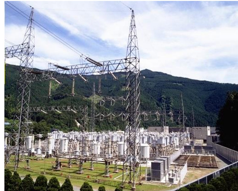
佐久間周波数変換所（30万kW、静岡県）
