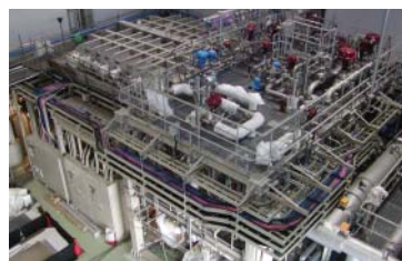
常圧150kW級SOFCシステム (茅ヶ崎研究所)
