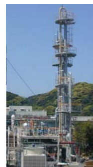
松島火力2号機におけるCO 2 分離回収 実証試験装置
