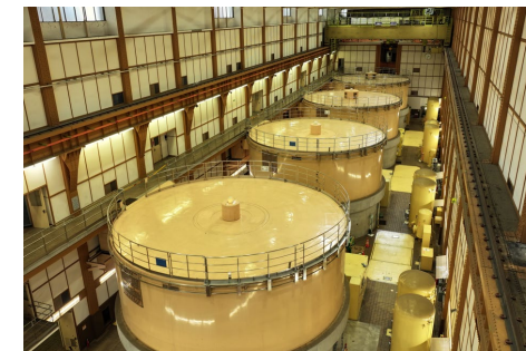
佐久間発電所 水車発電機
