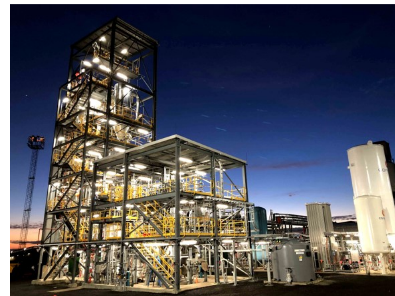
褐炭ガス化炉設備 写真提供：HySTRA
