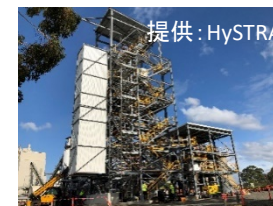
褐炭ガス化炉設備
