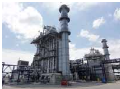
CRN (2013年7月、 運転中 )
