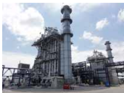
CRN (2013年7月、 運転中 )
