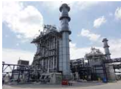
CRN (2013年7月、 運転中 )
