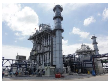
CRN (2013年7月、 運転中 )
