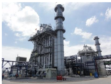
CRN (2013年7月、 運転中 )
