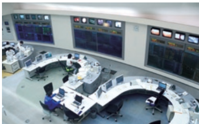
発電所 運転センター
