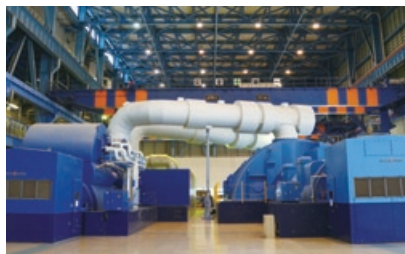
タービン 発電機
