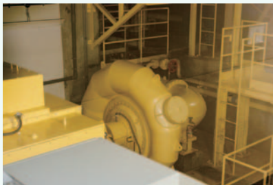
河川維持流量放流を利用した小型発電機（2,700kW）。
