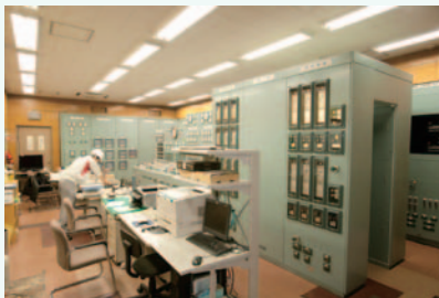
現在、常時は使われていない制御室。
