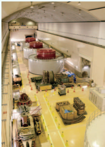
発電機の並ぶフロアは巨大な地下シェルターのよう。
