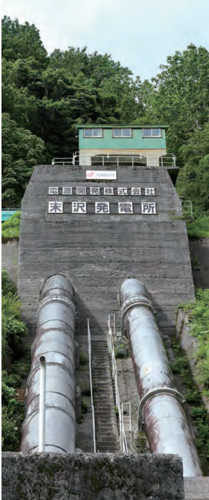
発電用の水を流す水圧鉄管（右）と使用しない水を川に流す余水管（左）。
