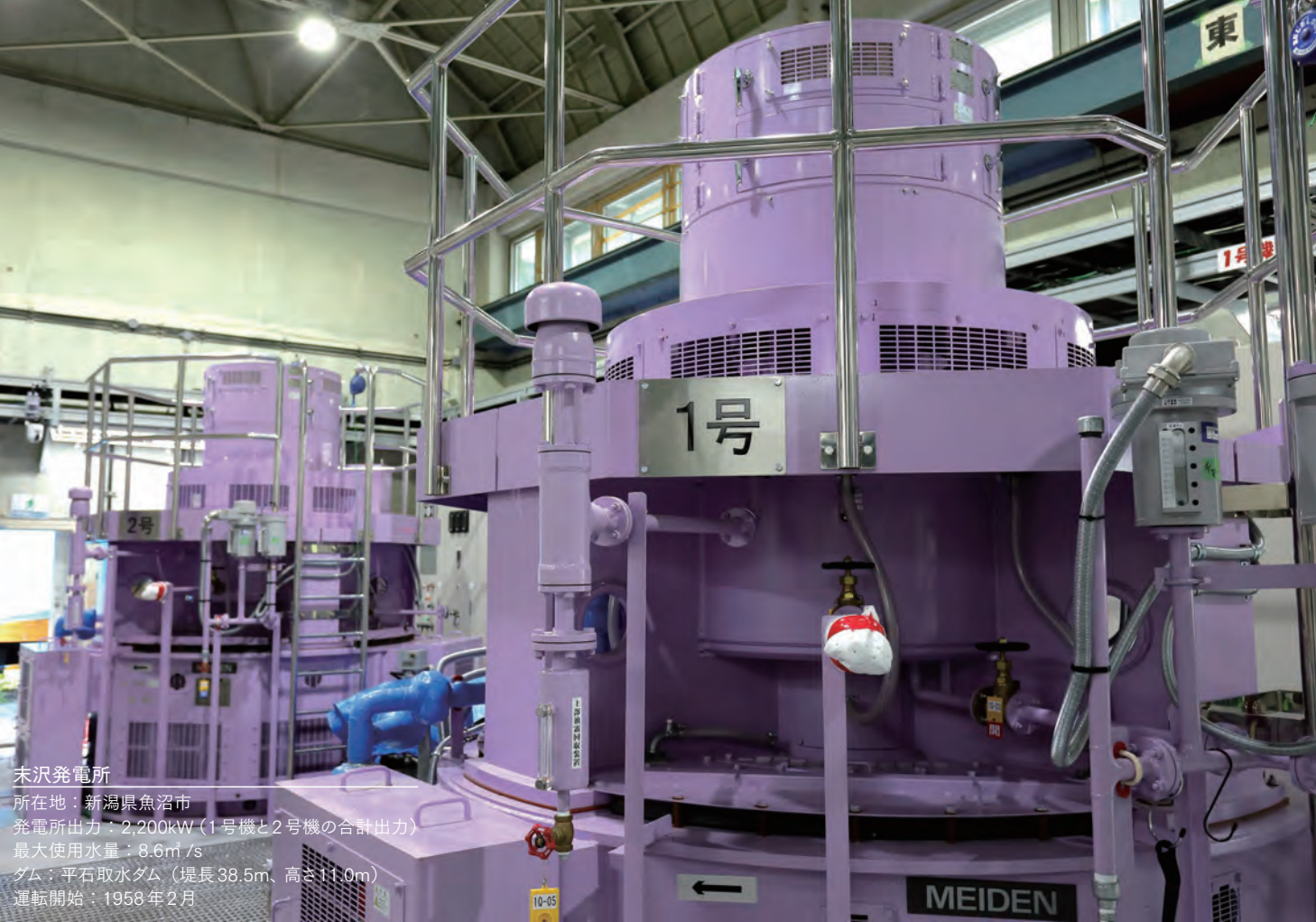
2024年にリパワリングを完了した水車発電機。1号機、2号機合わせて出力は2,200kW となり、以前より700kW 増加。
