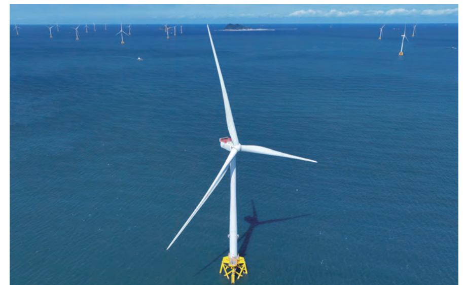
北九州響灘洋上ウインドファーム(風車羽根の最高点は海水面から約200m)
