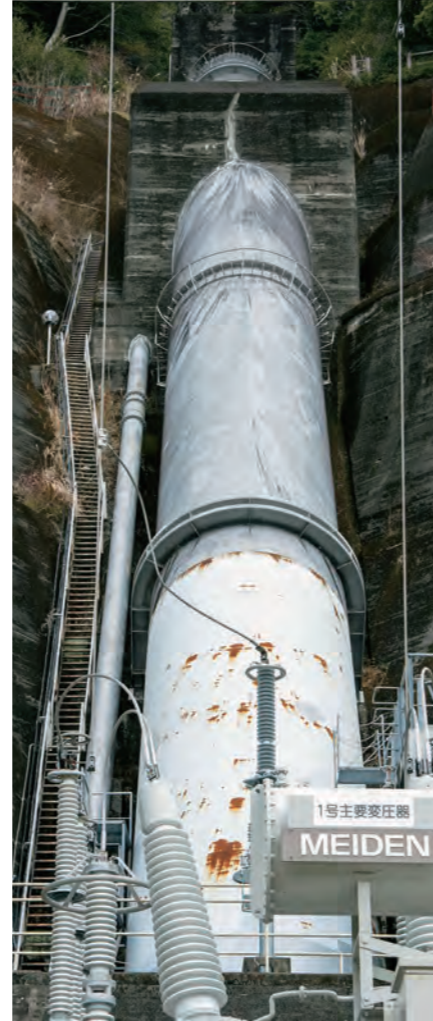
1秒間に40tの水が流れる水圧鉄管。
